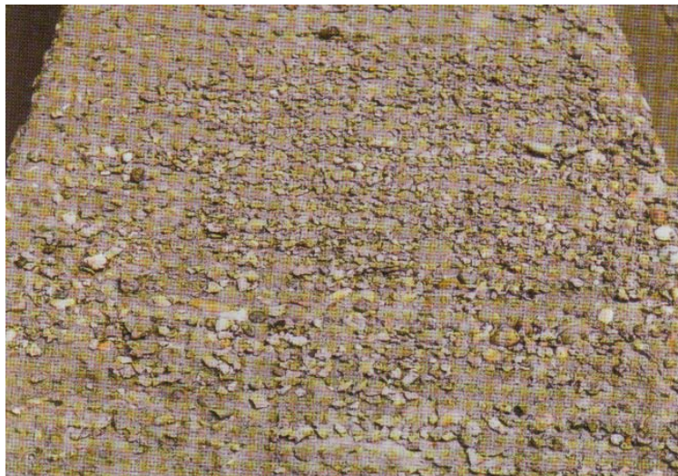
Abbildung 3: Abschalung der Betonoberfläche nach Frost-Tausalz Angriff [8]
