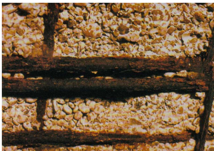
Abbildung 1: Betonabplatzung nach Karbonatisierung [8]
