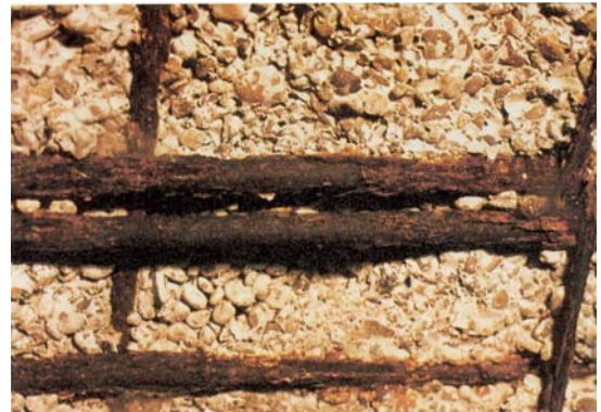
Bild 3 Korrodierte Bewehrungsstäbe (Betondeckung abgeplatzt) infolge Karbonatisierung
