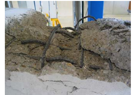
Abb. 10: Bild der Zerstörung Träger A3
